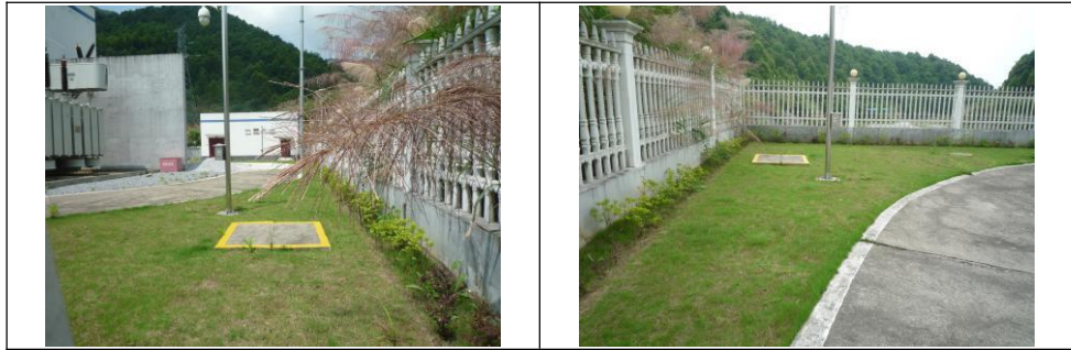
站内地埋式事故油池
