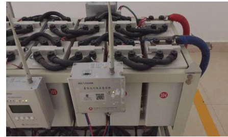
使用中的铅酸蓄电池
