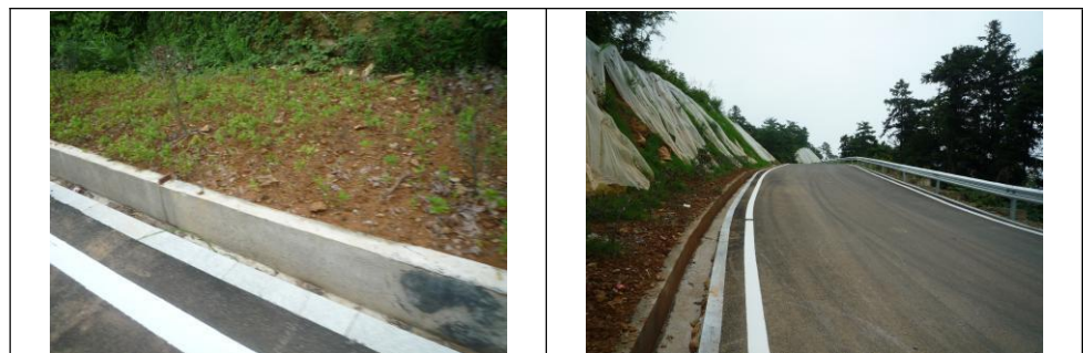
进场道路旁永久性排水沟
