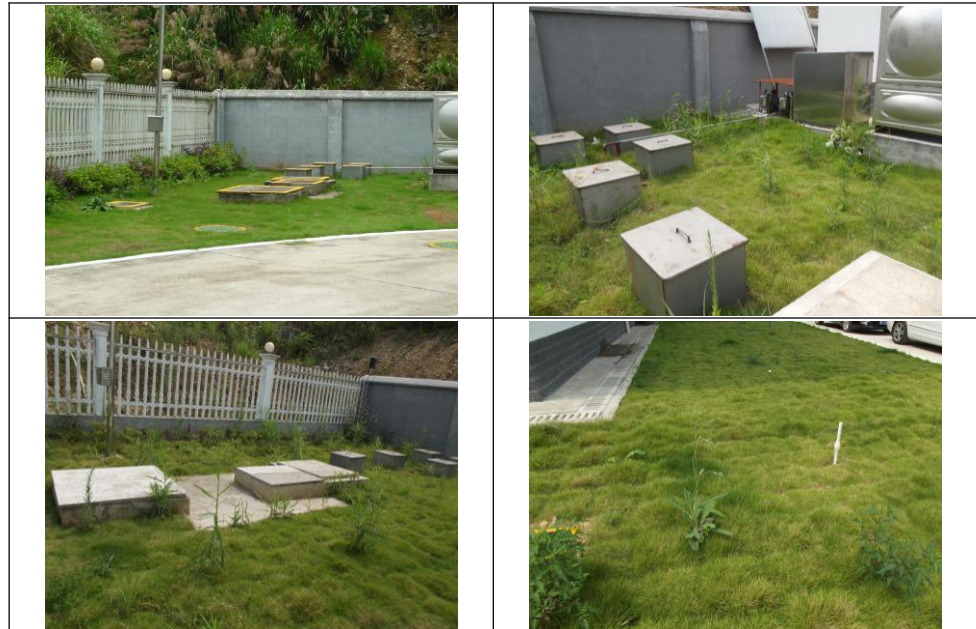
升压站一体化污水处理系统及绿化回用
