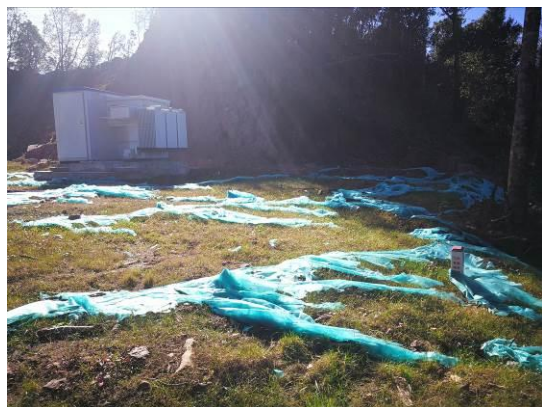
箱式变电站与集电线路
