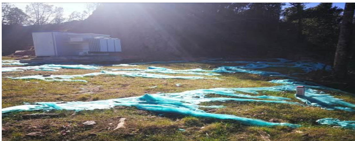
箱式变电站与集电线路
