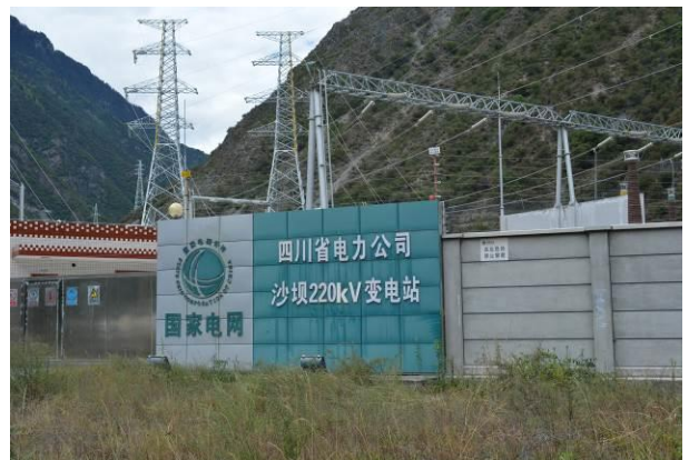
线路终点沙溪变电站
