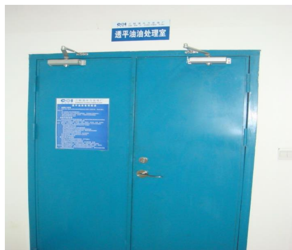
透平油处理室
