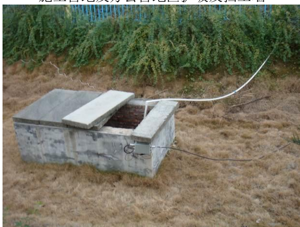
施工区生活集水池
