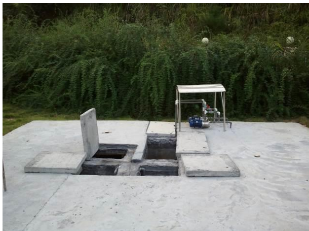
生活区污水处理设施
