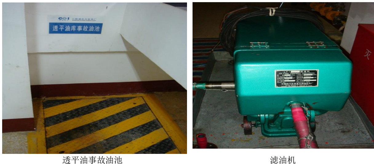
图 4.3-6 发电厂房事故油污处理设施
