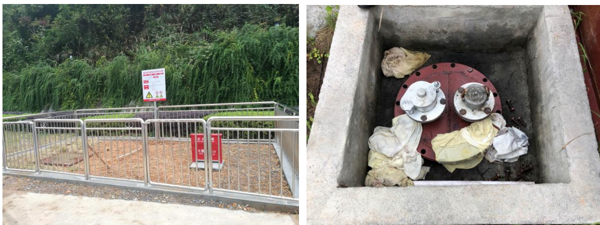
图 4.3-5 发电厂房地埋式储油罐
