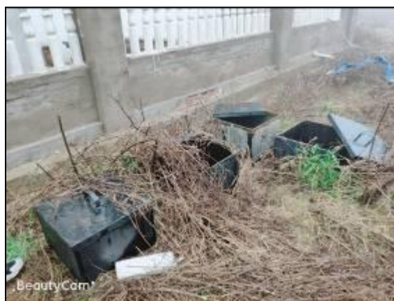
一体化处理装置
