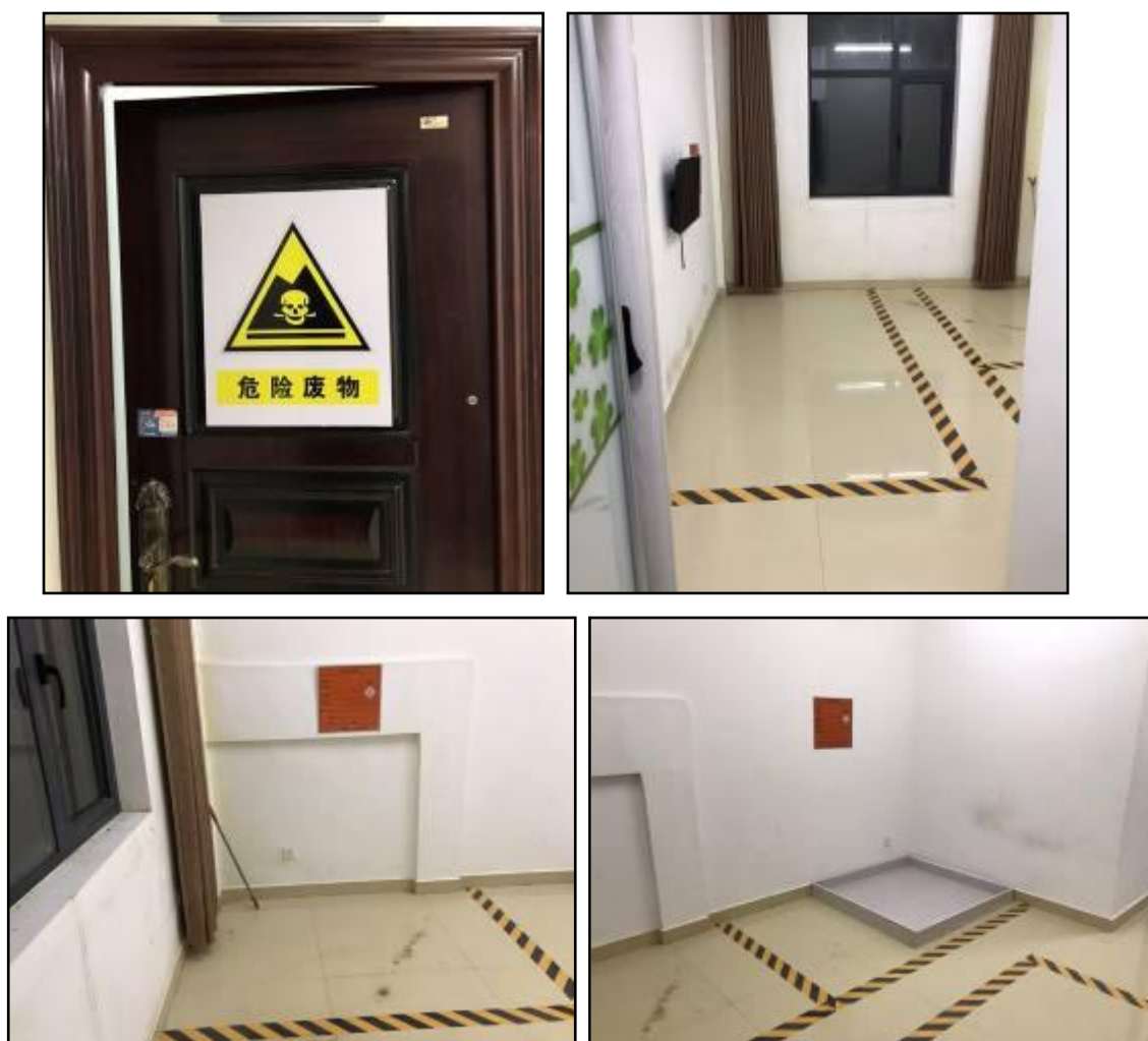
图 6.5-1: 危险废物暂存库照片
