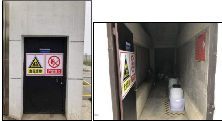
危险废物暂存间 1
