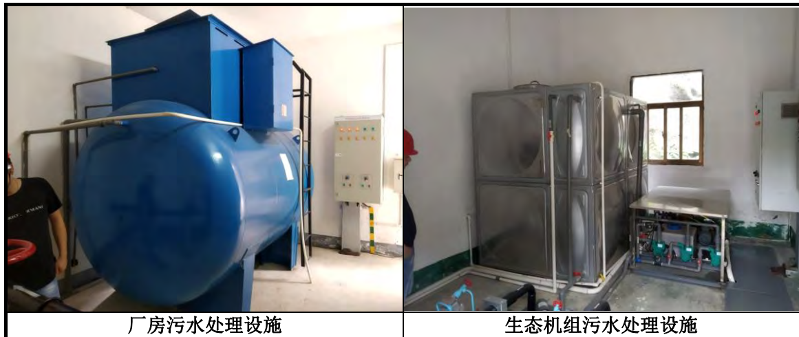
图 4.2-2 污水处理设施
