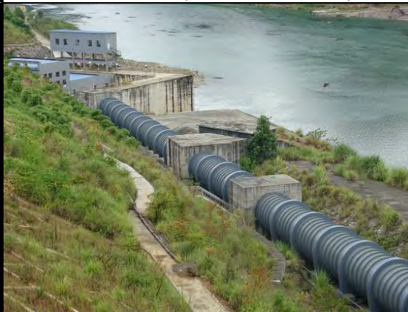
生态机组引水管
