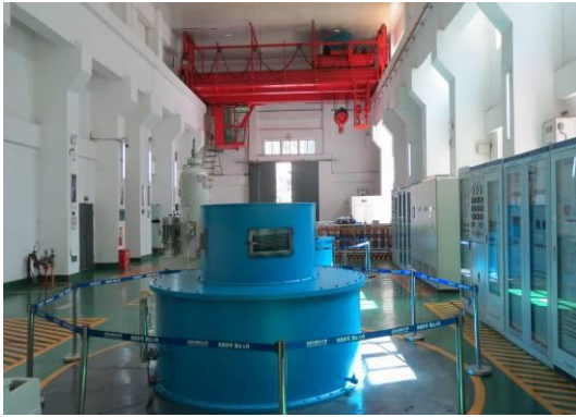
电站厂房内部
