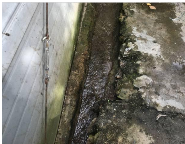
1#支洞口营区排水沟
