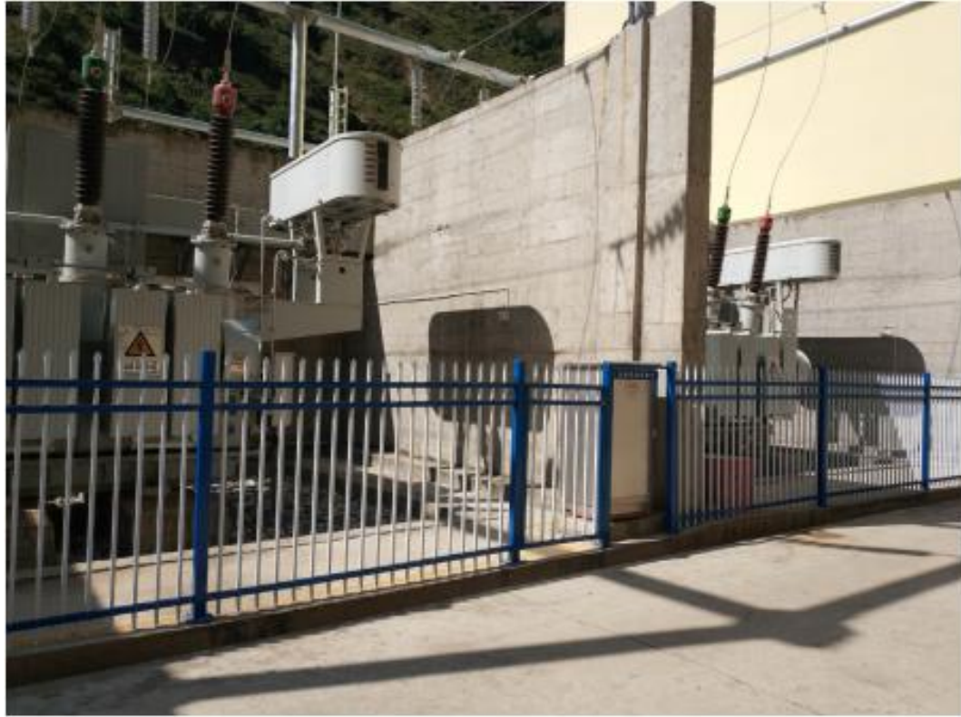
麻窝电站 110kV 升压站
