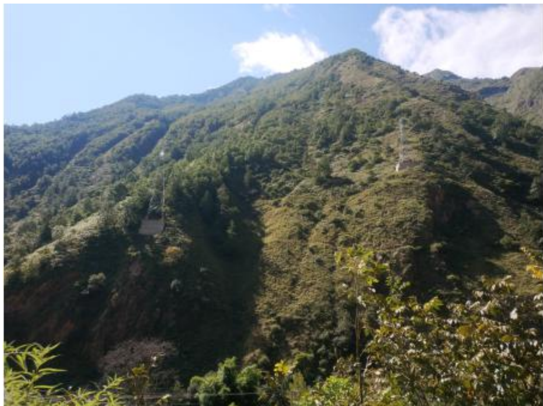
麻窝 110kV 送出工程沿线铁塔
