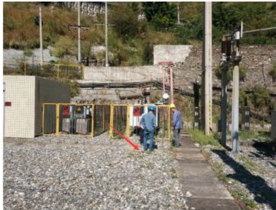
河口电站 110kV 升压站事故油池位置
