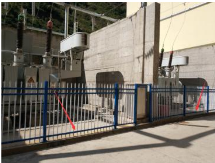
麻窝电站 110kV 升压站事故油罐位置
