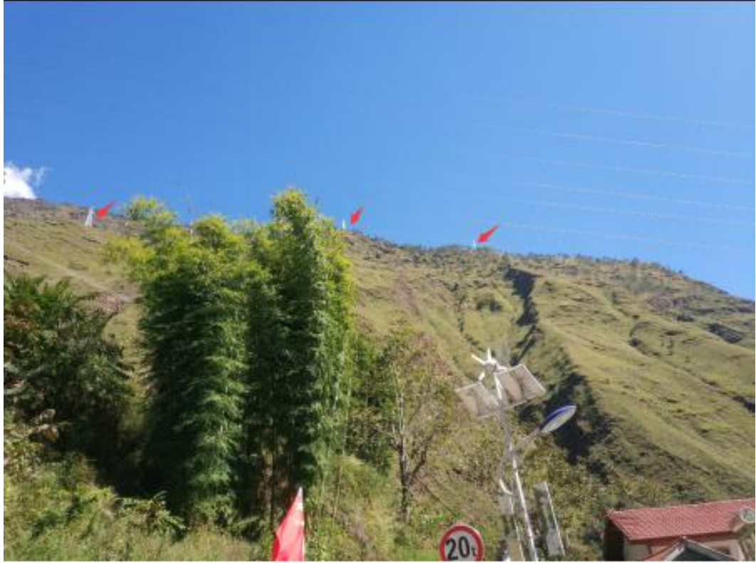
麻窝 110kV 送出工程沿线铁塔
