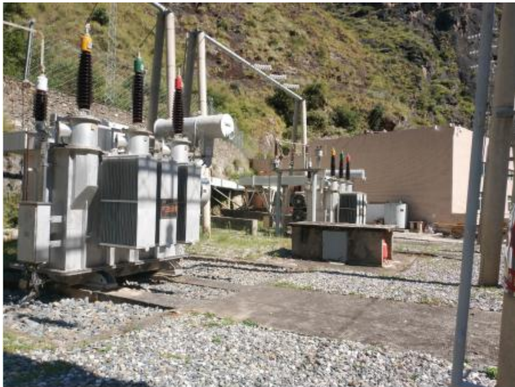
河口电站 110kV 升压站
