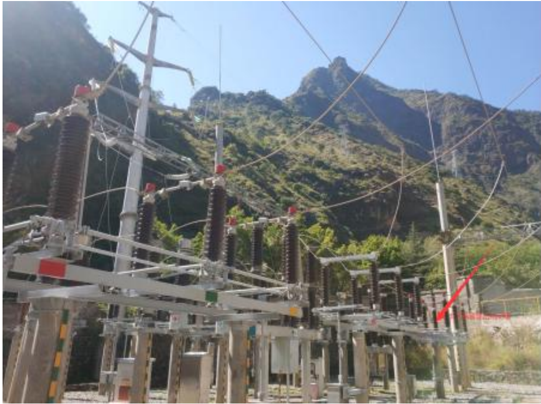
新建河口电站出线间隔
