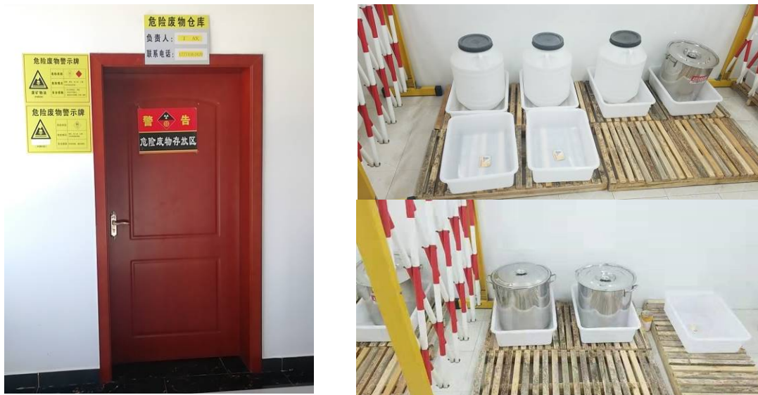
图 6.5-1 危险废物暂存库照片
