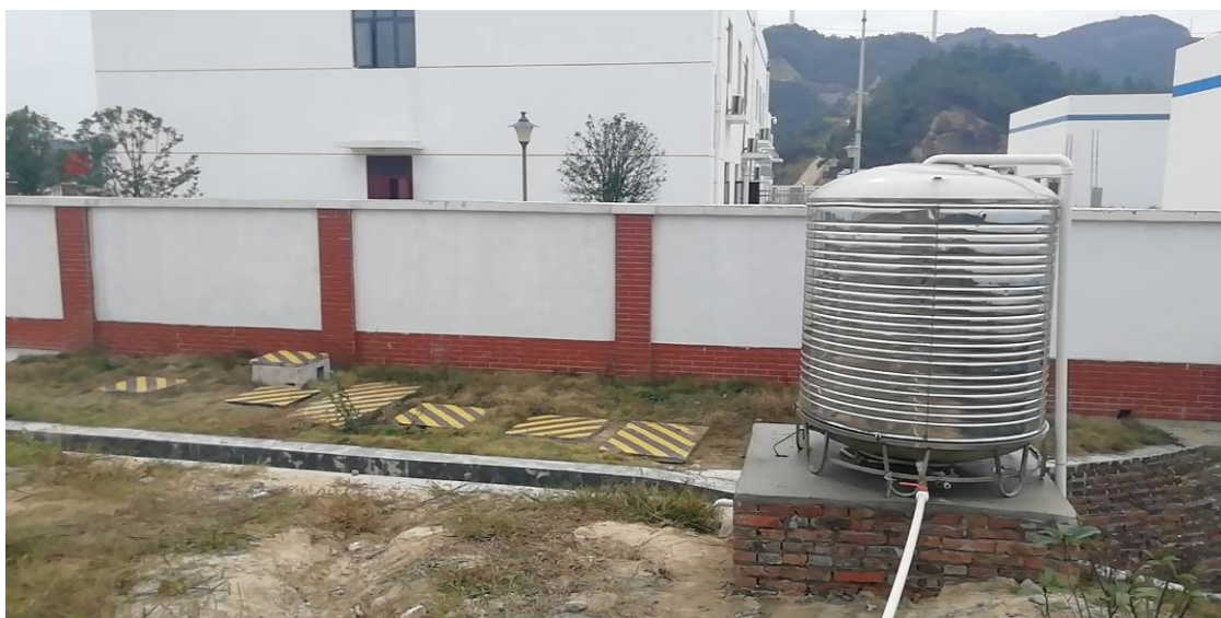
地埋式污水处理设施
