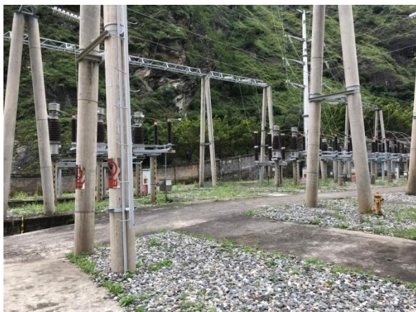
河口变电站区内
