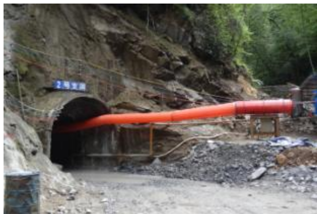
3#支洞临时道路滑坡道路清理
